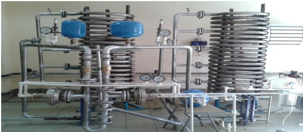
Рис. 4. Тепловой пункт с импульсной циркуляцией теплоносителя для независимого присоединения системы теплоснабжения
